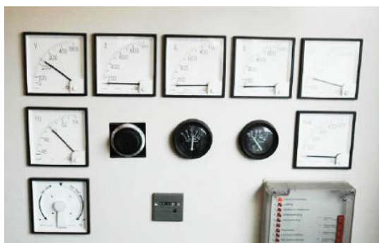
Instrumenter fra et nødstrømsanlæg.
