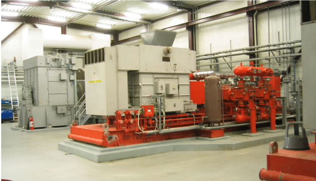
Abb. 3-4 Gebäude mit Verdichtern in Stenlille 15
