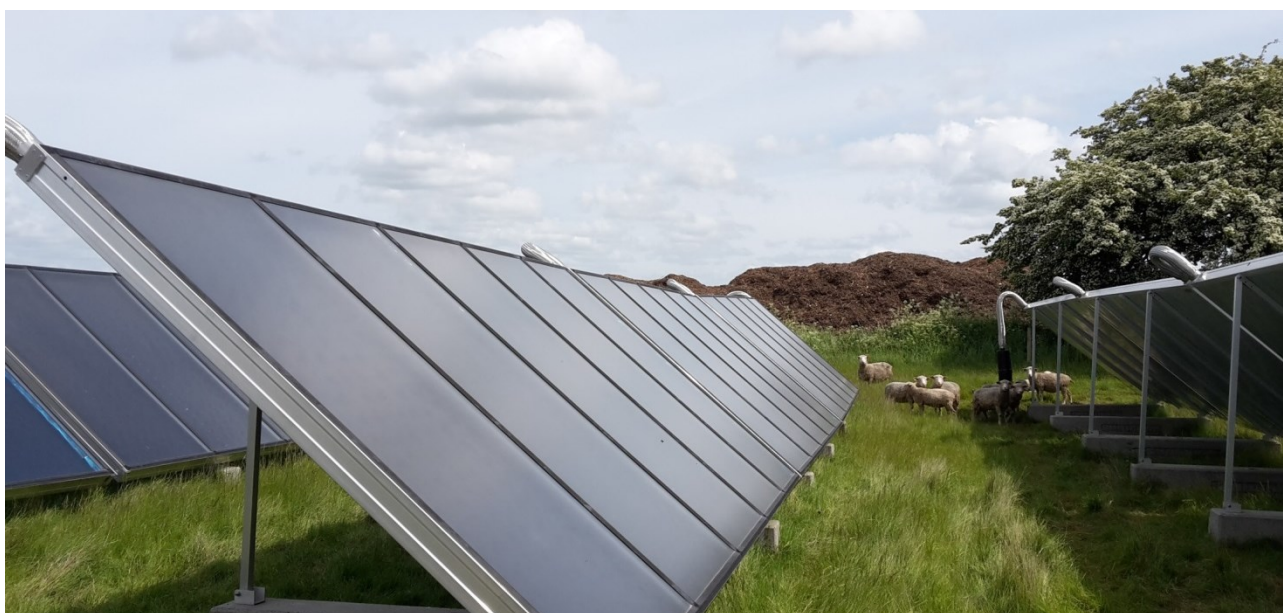
Figur 12. Solvarmeanlæg ved fjernvarmegærk
