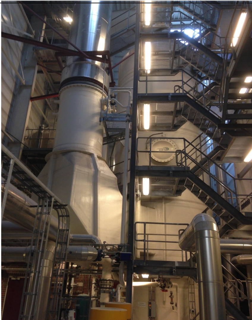
Figur 15: Røggaskondenseringsanlægget på Aars Varmeværk
