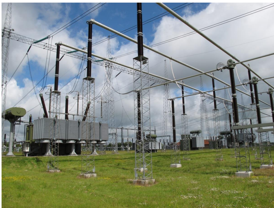
Stationsanlæg ved transformerstation Endrup
